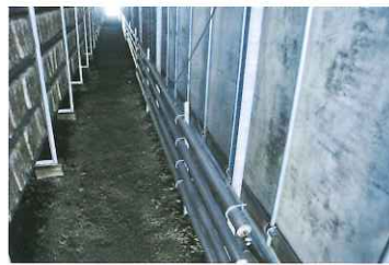
栽培棟ヒートパイプシステム
