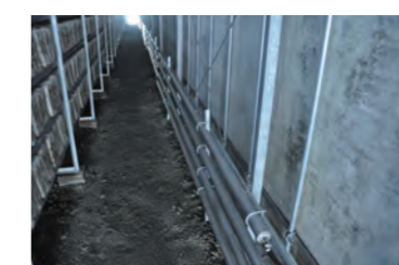
栽培棟ヒートパイプシステム
